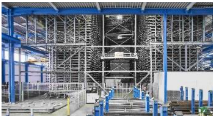
Bild 1: Herzstück des Neubaus beim Stahlhändler Hagelauer Dewald ist das Wabenlagersystem UNICOMPACT 3.5. Die Gesamtlagerkapazität liegt hier bei fast 14.000 Tonnen.
